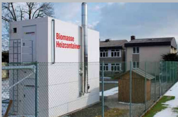
Doppelstock-Hackgut-Heizcontainer neben einer Schule.
