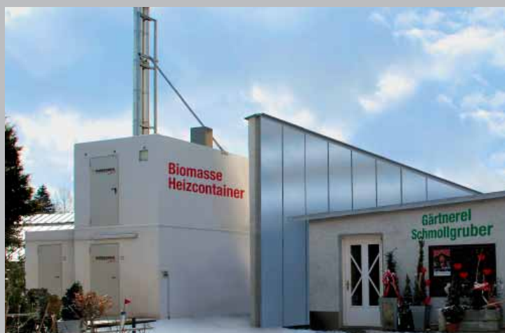
Dreifach-Hackgut-Heizcontainer bei einer Gärtnerei.
